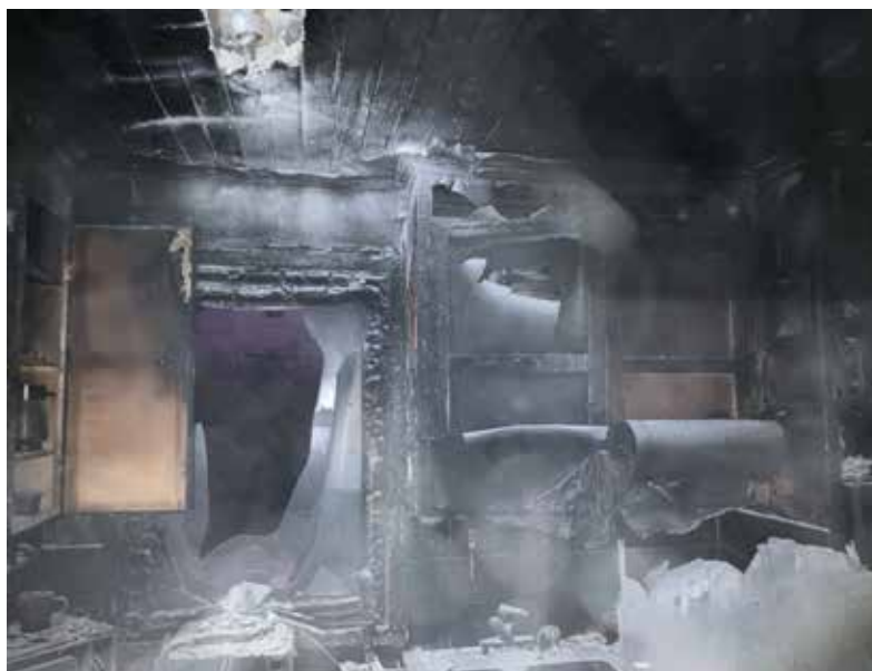
Köket som är kraftigt brandskadat.
