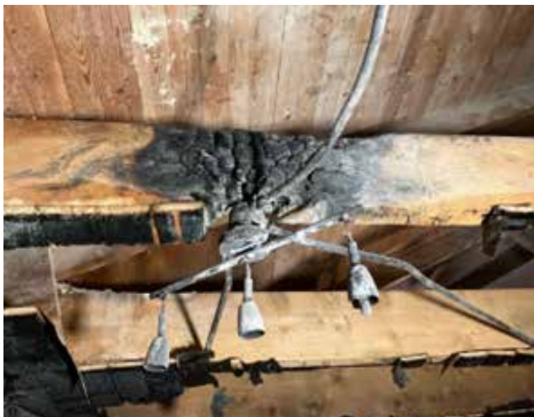
Kolad bjälke vid taklampa.
